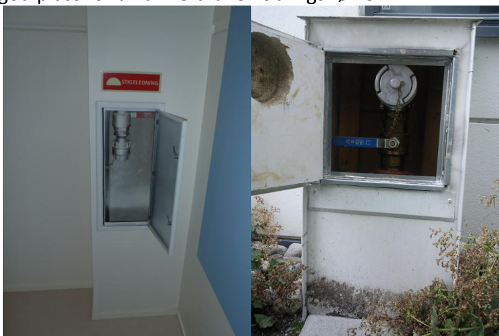
Feil plassering av uttak og påkoblinger.
