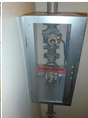
Eksempel på god beskyttelse av stigeledning
